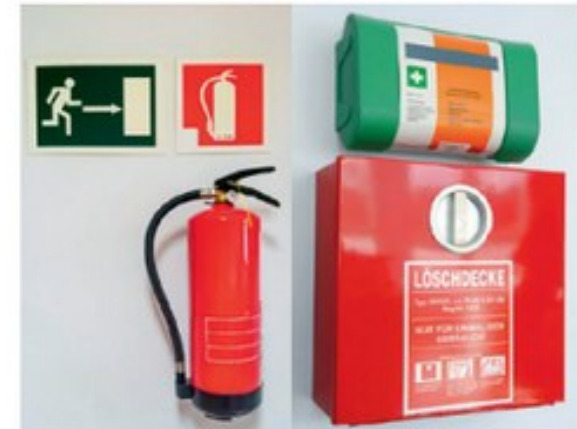
3 Feuerlöscher, Fluchtweg, Löschdecke und Erste-Hilfe-Kasten
